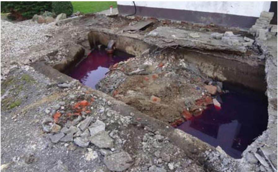
Über einen undichten Tank fanden 4.000 l HEL u.a. den Weg in diese verüllte 3-Kammer-Klärgrube
